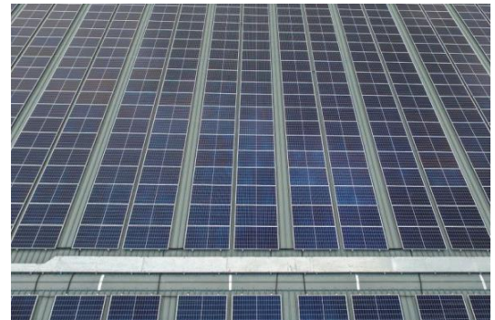
設置した太陽光パネル
